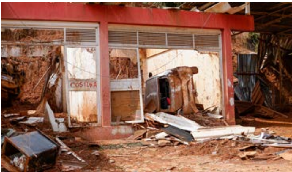
Estrago causado pela chuva deixou um rastro de destruição em Santa Maria
