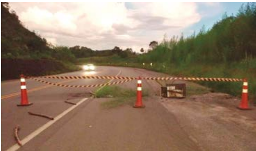
Desnível em lugar perigoso aumenta risco de acidentes na BR-356
