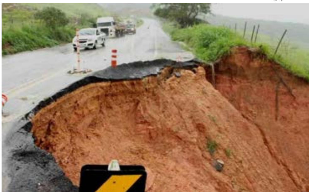
Buraco aberto na BR-262, em Rio Casca, interditada meia pista.
