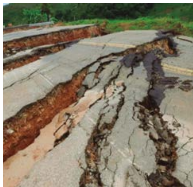
Deformação que causou a interdição da BR-262, em Abre Campo
