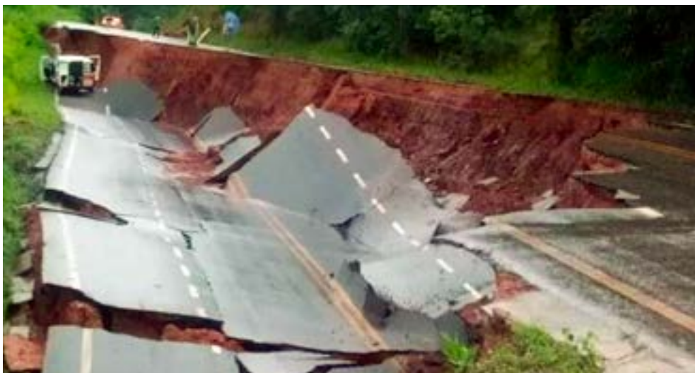
Uma ambulância trafegava pela LMG-743 no momento em que a pista cedeu.
